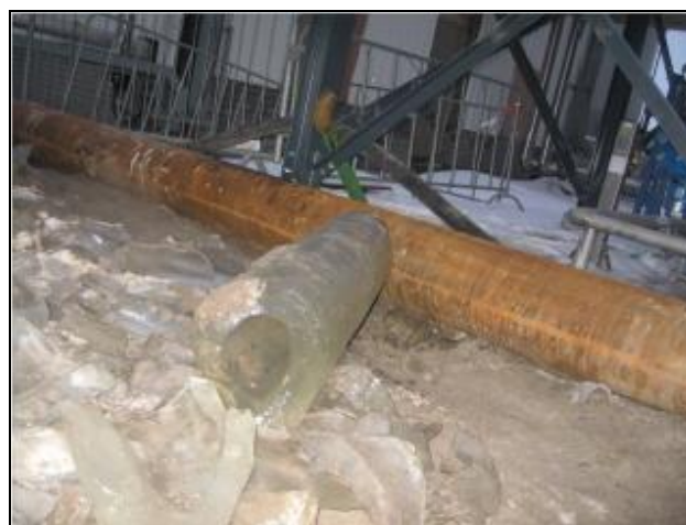
Rysunek 4. Po usunięciu lodu z rurociągu wody demineralizowanej.
