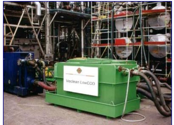
Foto 1: Industriële reiniging met Veclean LowCOD
