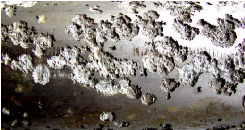
Putcorrosie aan AISI 316 leiding
