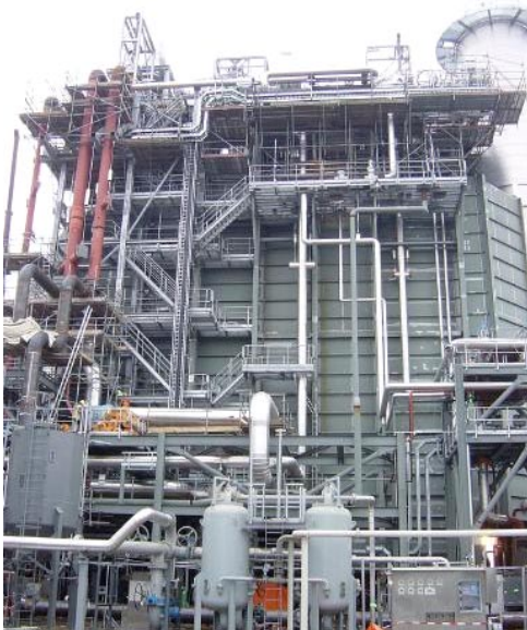
Fig. 1: Rijnmond energie centrale
