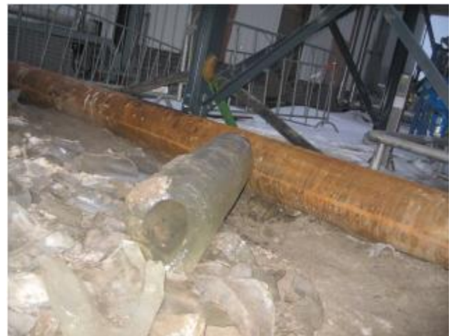
Foto 4: Ijs verwijderd van demiwatertleiding
