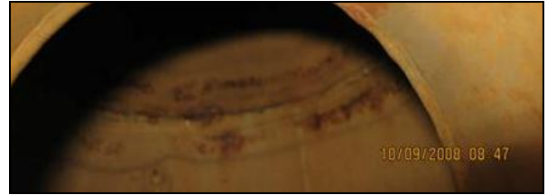
Leiding 3 bij de verplaatsbare pompaansluiting – De lasnaad is aangetast en vertoont tekenen van een grootschalige aanwezigheid van corrosieve producten
