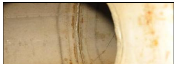
Leiding 5SB bij de verplaatsbare pompaansluiting (voorgaande aan de behandeling) – De lasnaad is aangetast en vertoont tekenen van een grootschalige aanwezigheid van corrosieve producten
