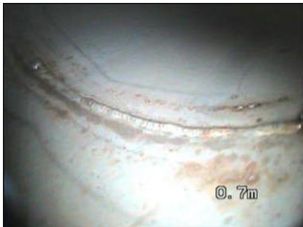
Leiding 5SB (voorafgaande aan de behandeling) – De lasnaden zijn aangetast door een substantiële aanwezigheid van corrosieve producten
