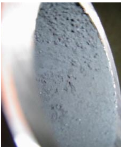
Magnetiet aanslag voor reiniging Rechtsboven: de magnetiet aanslag is verwijderd
