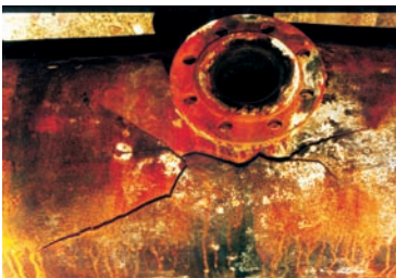
Afbeelding 8 SCC door nitraat a.g.v. inwatering in isolatie ter plaatse van tubelure.
