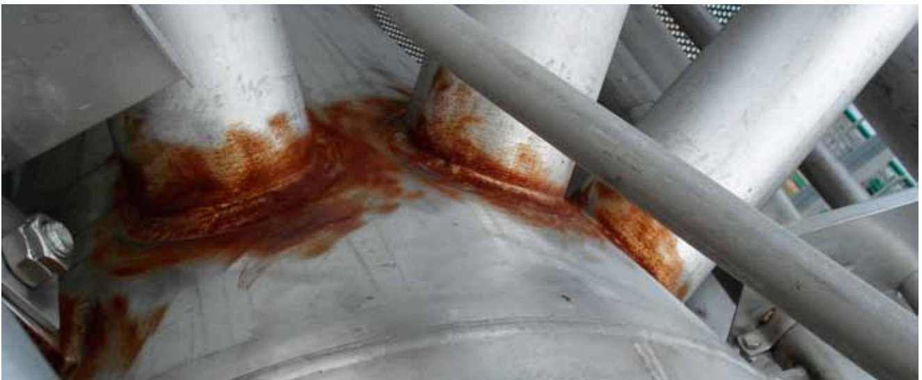
Hier is duidelijk te zien welke bewerking tot corrosie heeft geleid, de lasverkleuring is met stalen borstels na geslepen.
